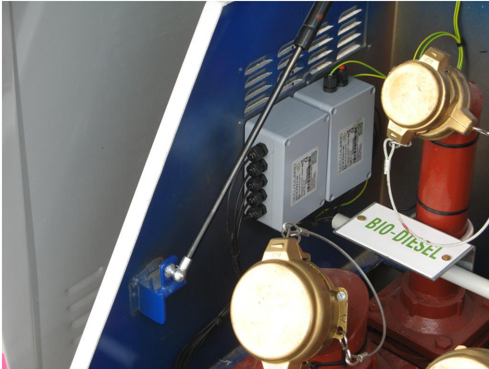
Praxisbeispiel Einbau zweier Geräte im Befüllschacht für 5 Tanks mit 5 Gaspendelleitungen
